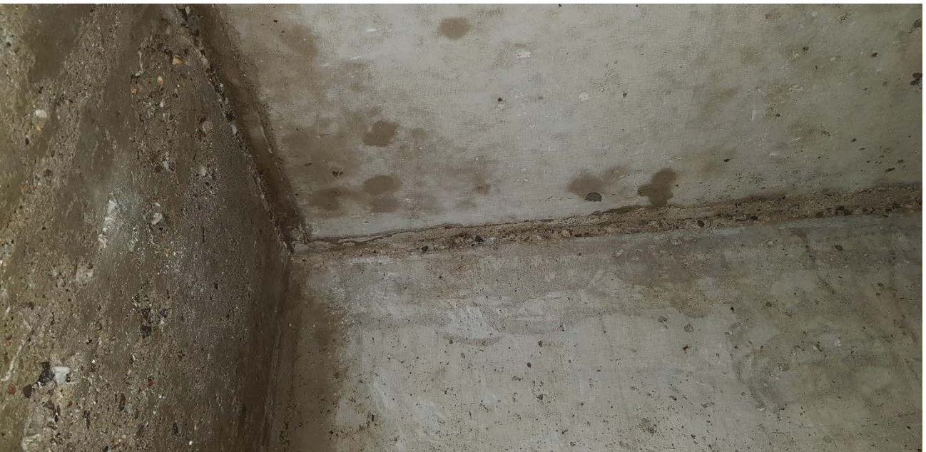
Oberer Wandbereich und Eckenbereich nach Entfernen der Putzreste. Bei den vereinzelt weißen Stellen im Beton handelt es sich um helle Steine und nicht um Putzreste.
